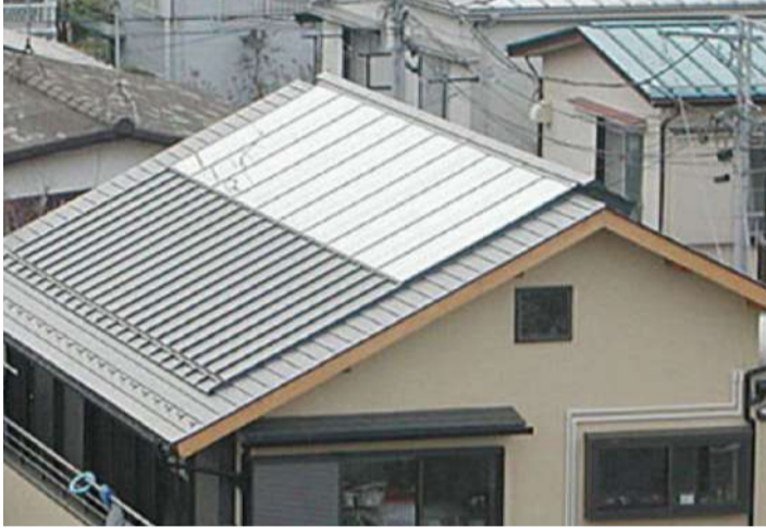
空気集熱式ソーラーシステムの屋根の集熱部 (出典: ネットワークたよりNo.47)
